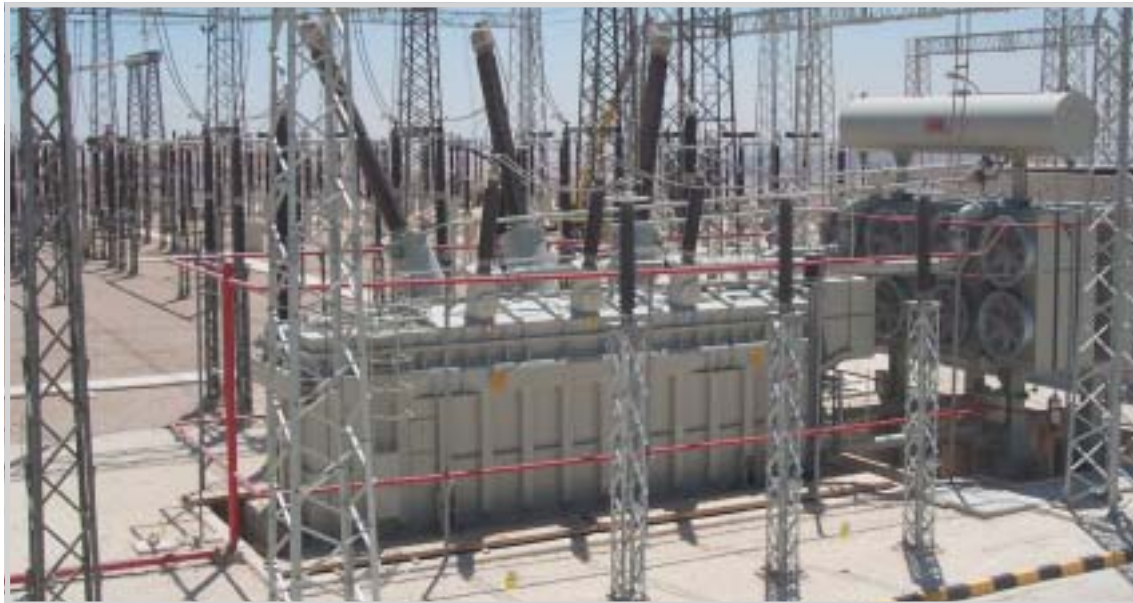
محطة تحويل شمال عمان 33/132/400 ك.ف
