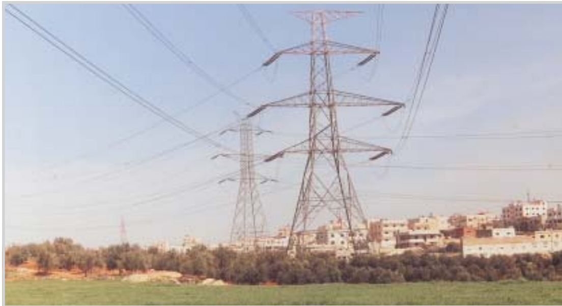
خط نقل 400 ك.ف يربط محطة تحويل جنوب عمان بمحطة تحويل العقبة
